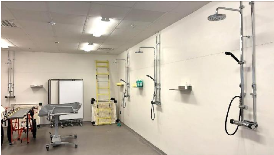
Figur 47 Saneringsrom for CBRNE ved akuttmottaket Linköping sykehus, Sverige. Rommet ligger inntil ambulanshallen. Foto: Sykehusbygg HF
