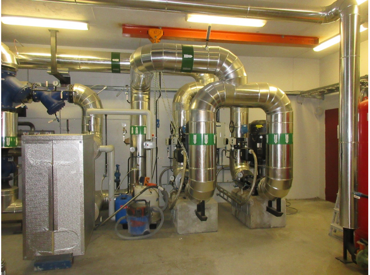
Figur 3. Varmesentral (fjernvarme) Lillehammer sykehus (Foto: Sykehusbygg HF)
