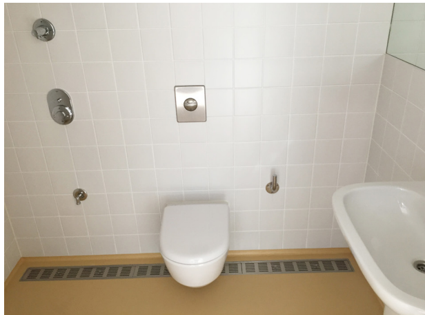
I wc/duschrum i Slagelse är installationer och reglage integrerade och utformade för att undvika fästpunkter som ett sätt att minska risken för självskada.
